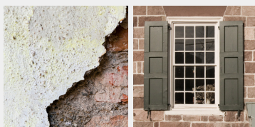
Enduit amianté extérieur et intérieur
